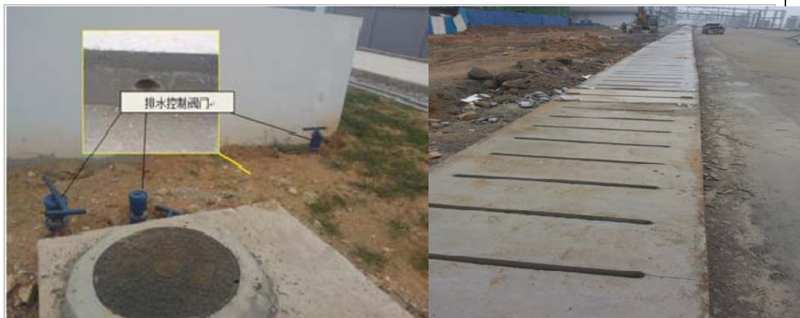
排水控制阀门 雨水管道
